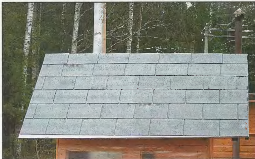
Это не Топ-Шингл компании Tegola! Крыша небольшого строения покрыта пластинами, нарезанными из рулона стеклоизола.
