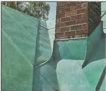
Воротник каминной трубы, частично перекрывающей ендову.
