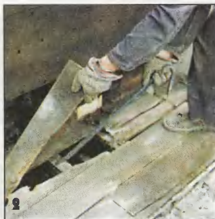
2 Все поврежденные или сгнившие деревянные детали следует заменить, будь то доски обрешётки или другие элементы конструкции.
